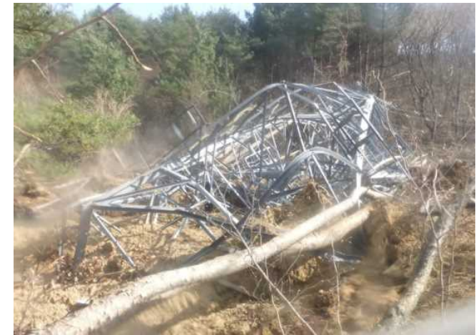
写真：5/6号機側鉄塔【地震の怖さ】
